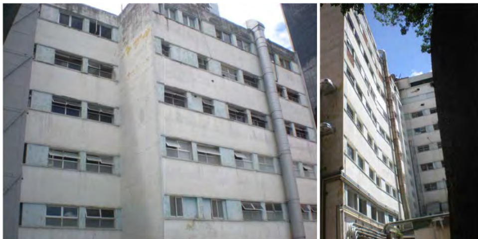
Figura 12.14 Fachadas Oeste y Este del Módulo 1 del Hospital J. M de Los Ríos
