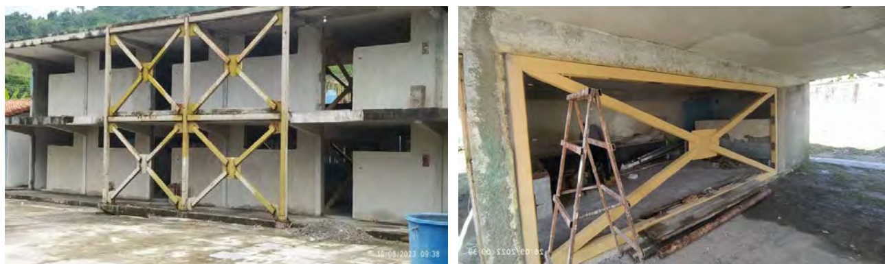
Rehabilitación Integral en ejecución en la U.E. "Guillermo Gamarra", Biscucuy, Edo. Portuguesa (Tipo Antiguo I). Proyecto de Refuerzo Estructural Ing. Leonardo López.
