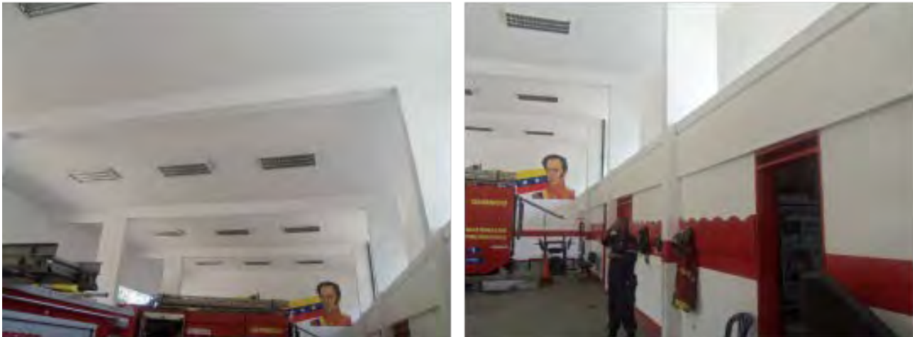
Figura 13.3. A la izquierda (a), se observa la ausencia de vigas en sentido longitudinal. Derecha (b), se observa el fenómeno de columna corta.
